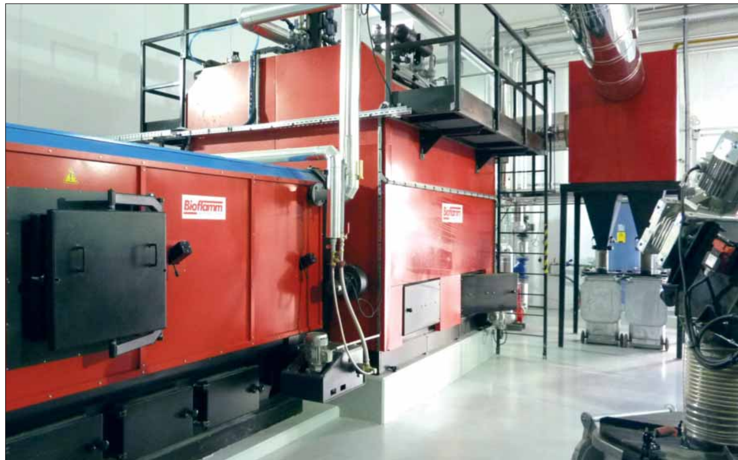
Nahwärme für ein Wohngebiet – Traversalrostfeuerung im Biomasseheizwerk
