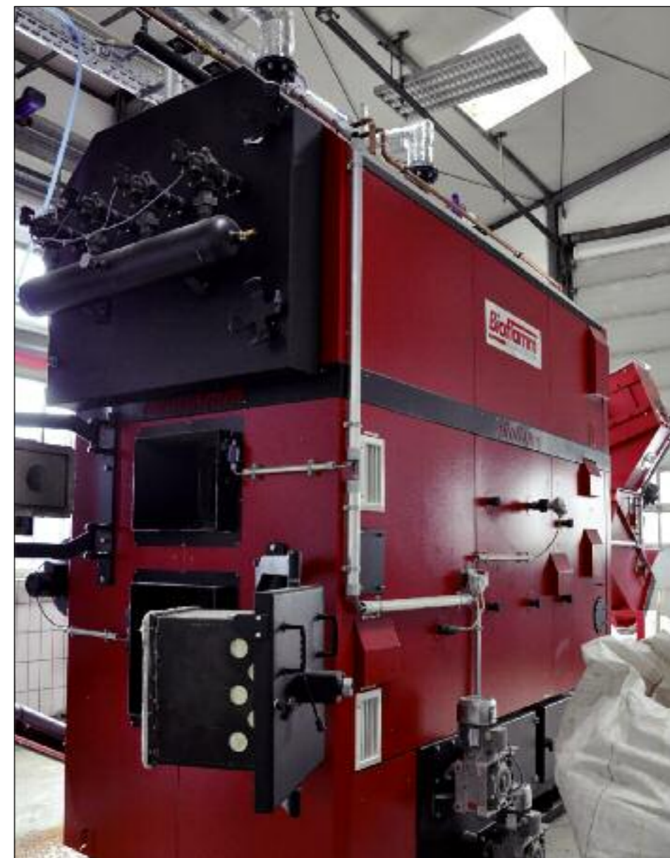
TRF-RK-Kessel im Biomasseheizwerk
