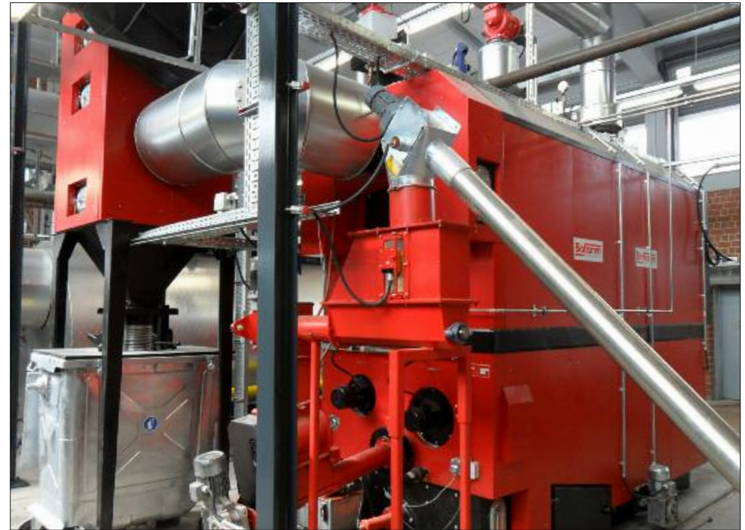
SRF-RK im Biomasseheizwerk
