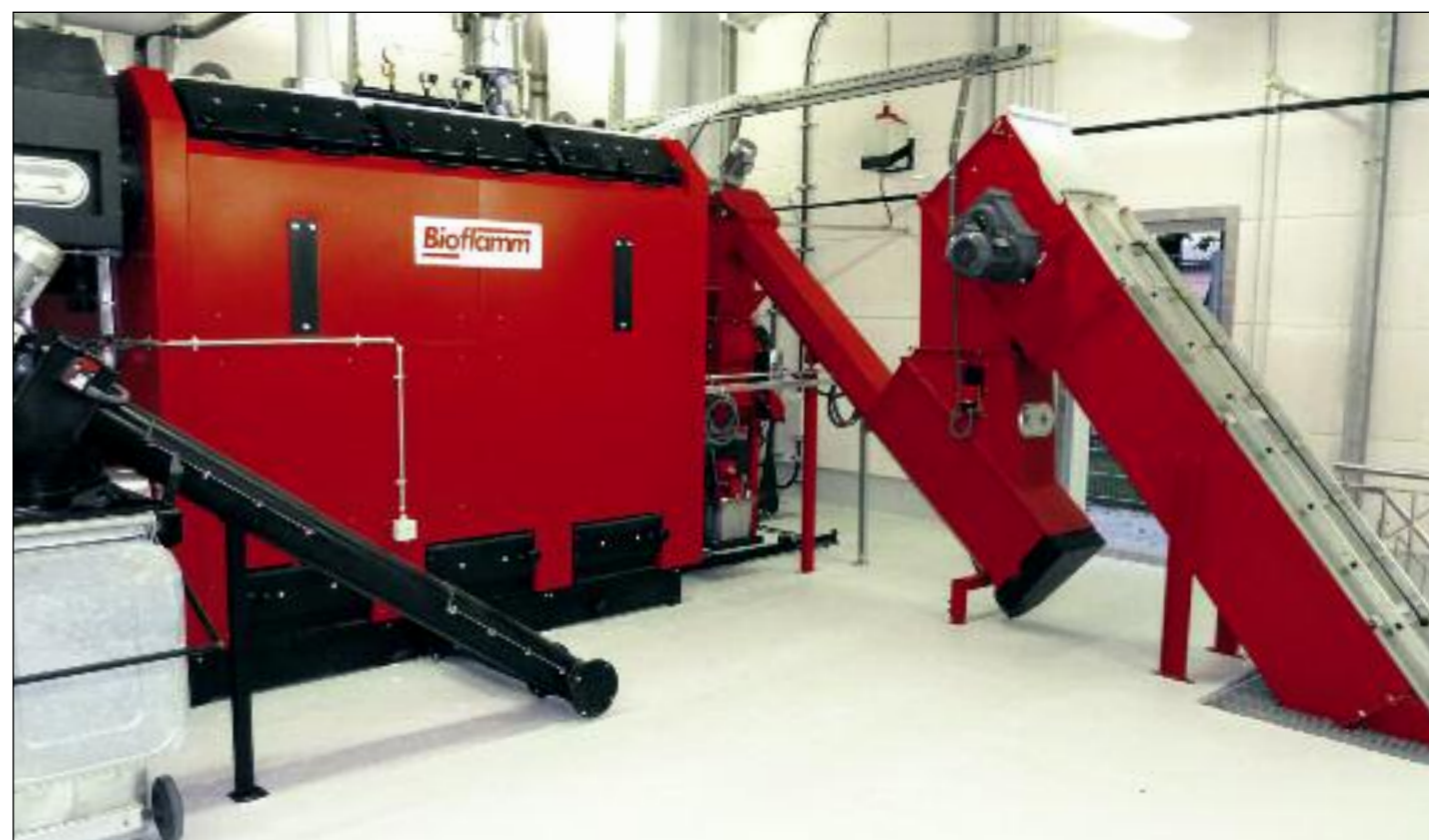
Umweltfreundliche Wärme aus Holzhackschnitzeln - Bioflamm® Integralfeuerungsanlage mit Nahwärmenetz
